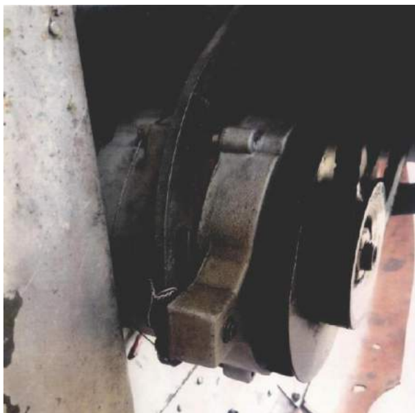
Фото 4.1. Общий вид генератора.
