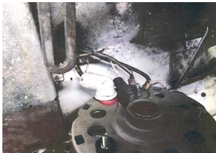
Фото 4.2. Состояние клемм подключения генератора к бортовой сети.
