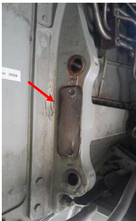
Рис. 11. Трещина в нижней части внешнего фитинга крепления узла «А» ООШ правой
