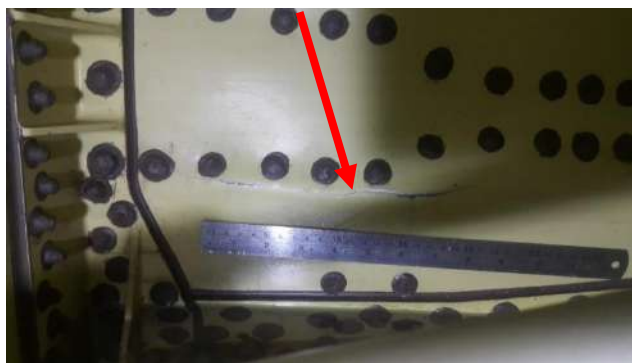
Рис. 22. Вид изнутри на стенку заднего лонжерона в зоне крепления кронштейна гидроцилиндра уборки-выпуска ООШ левой. Видна трещина в стенке длиной \approx 210 мм
