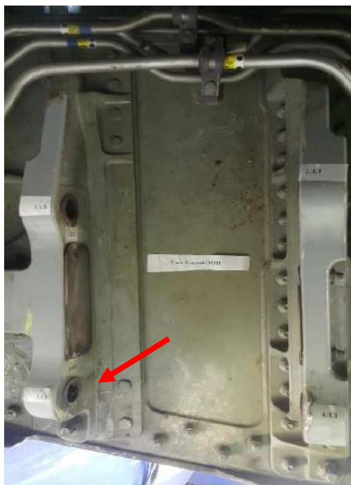
Рис. 9. Трещина в нижней части внешнего фитинга крепления узла «А» ООШ левой
